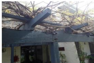
Replace Rotten Pergolas
